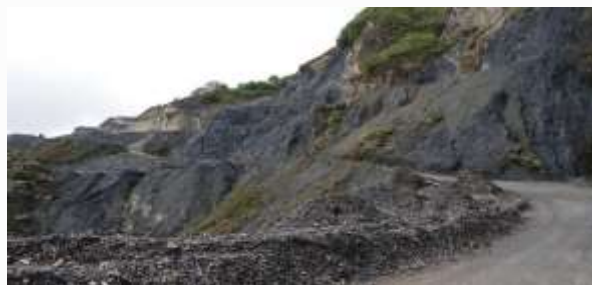
Figura Zona de influencia del trazo de la falla San Jerónimo, afectando el Complejo Quebradagrande
